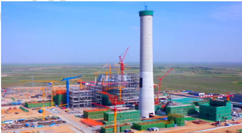
图 10-3 某火电厂 5G 专网项目
